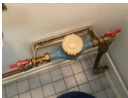
Kulventiler med vattenmätare emellan.
